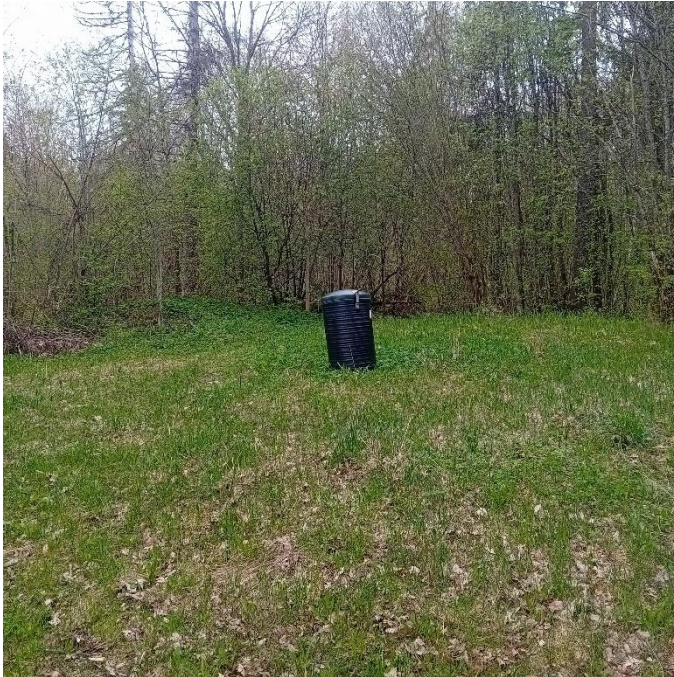
Joonis 5-7 Puka Tööstuse puurkaevu päis paikneb pumplahoone taga
