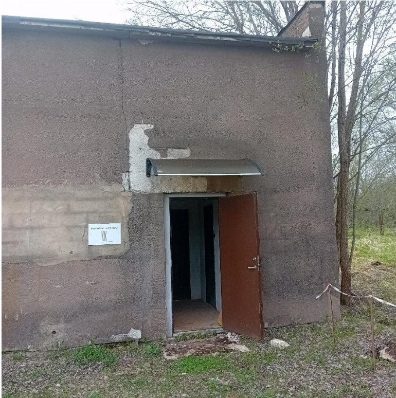
Joonis 5-9 Sangaste puurkaevpumpla hoone välisilme
