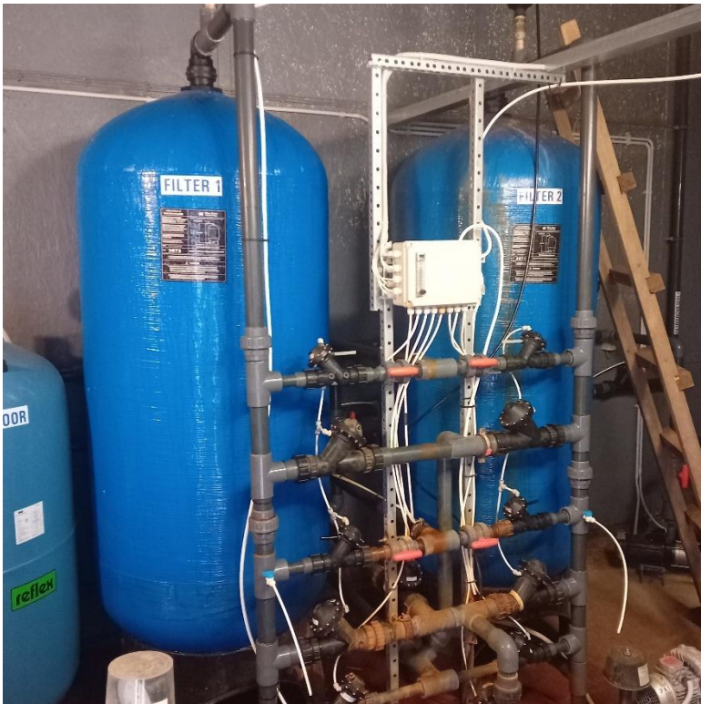
Joonis 5-10 Sangaste pumplahoone sisevaade, paralleelsed survefiltrid
