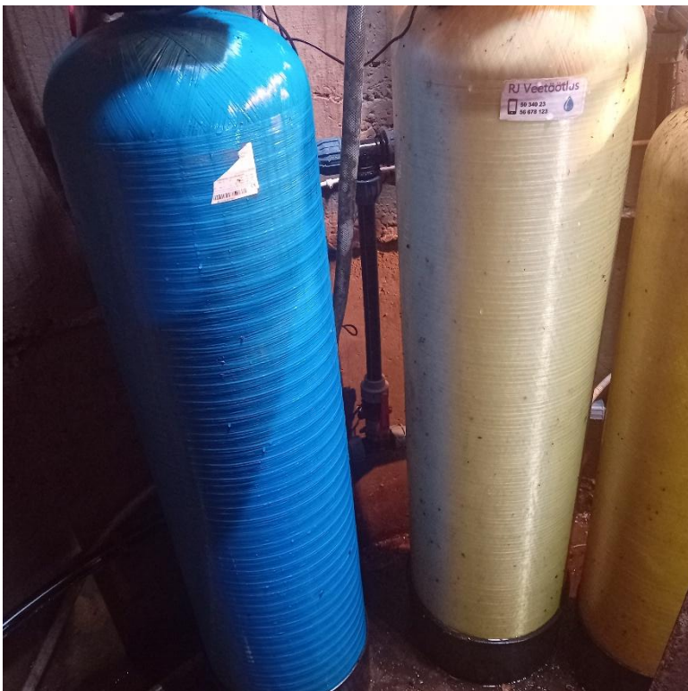
Joonis 5-15 Nõuni keskuse pumpla sisevaade. Šahtis paiknevad aeratsioonimahuti ja paarisfilter
