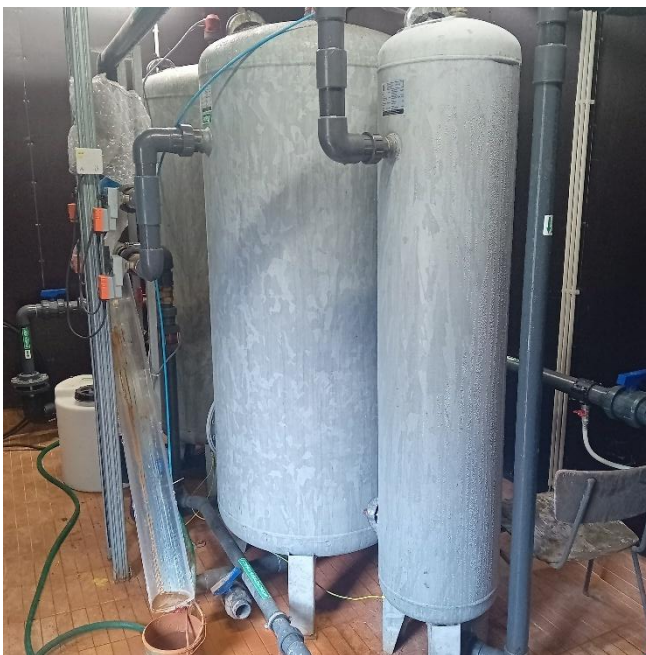
Joonis 5-8 Tööstuse puurkaevpumpla sisevaade, eelaeratsioonimahuti ja paarisfilter
