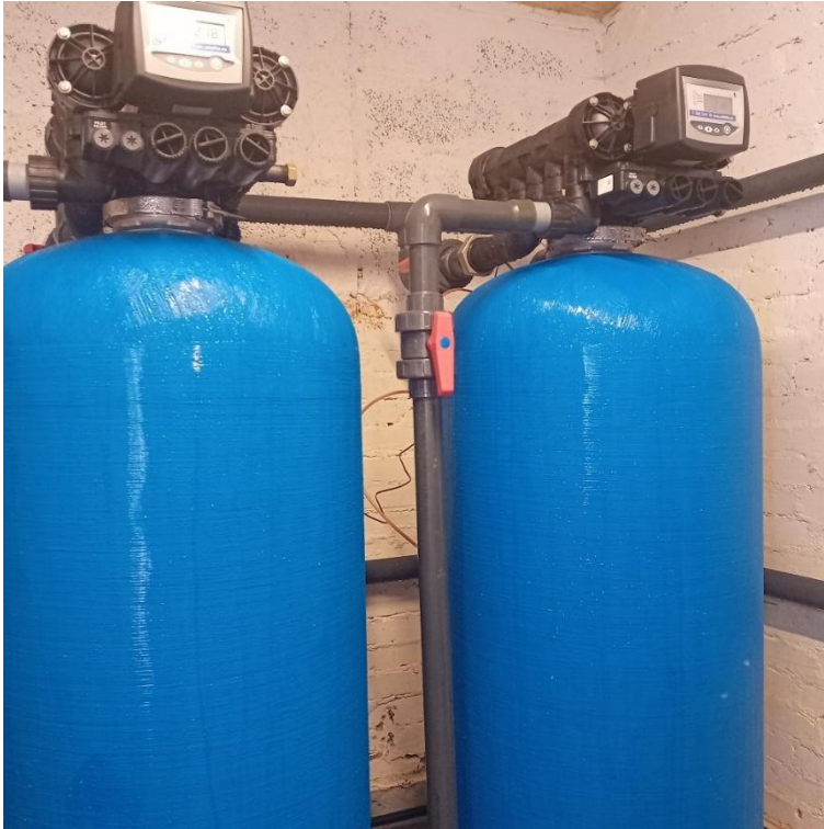
Joonis 5-6 Puka Ääre tn pumplahoone sisevaade, kolmest survefiltrist kaks
